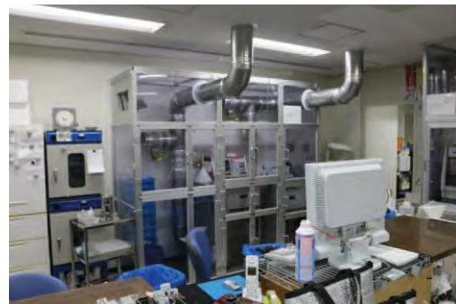
自動包埋装置 (囲い式局所排気装置)
