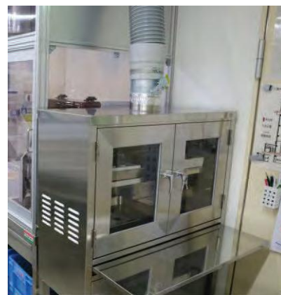
検体受付台（囲い式局所排気装置）
