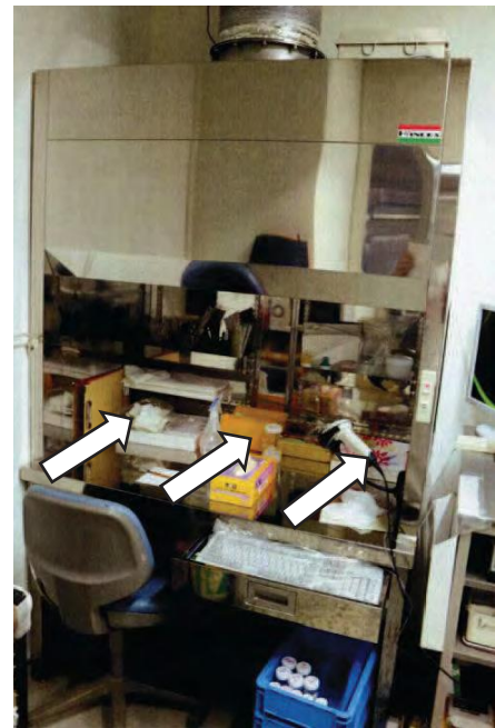
切出台用の囲い式局所排気装置
